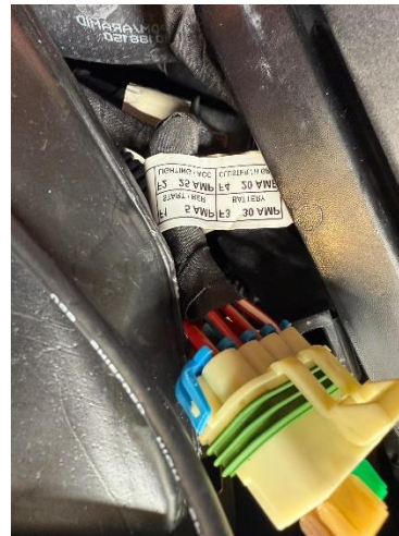
Sikringsboks er vedsiden av diagnosekontakt
